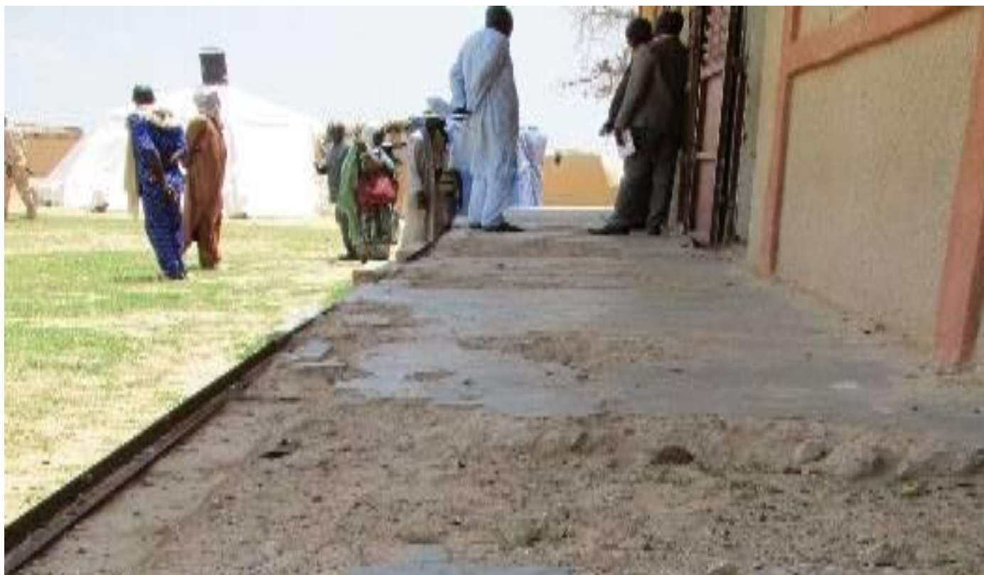
Photo 1 : Dégradation de la terrasse à l'école primaire Maloumdi
