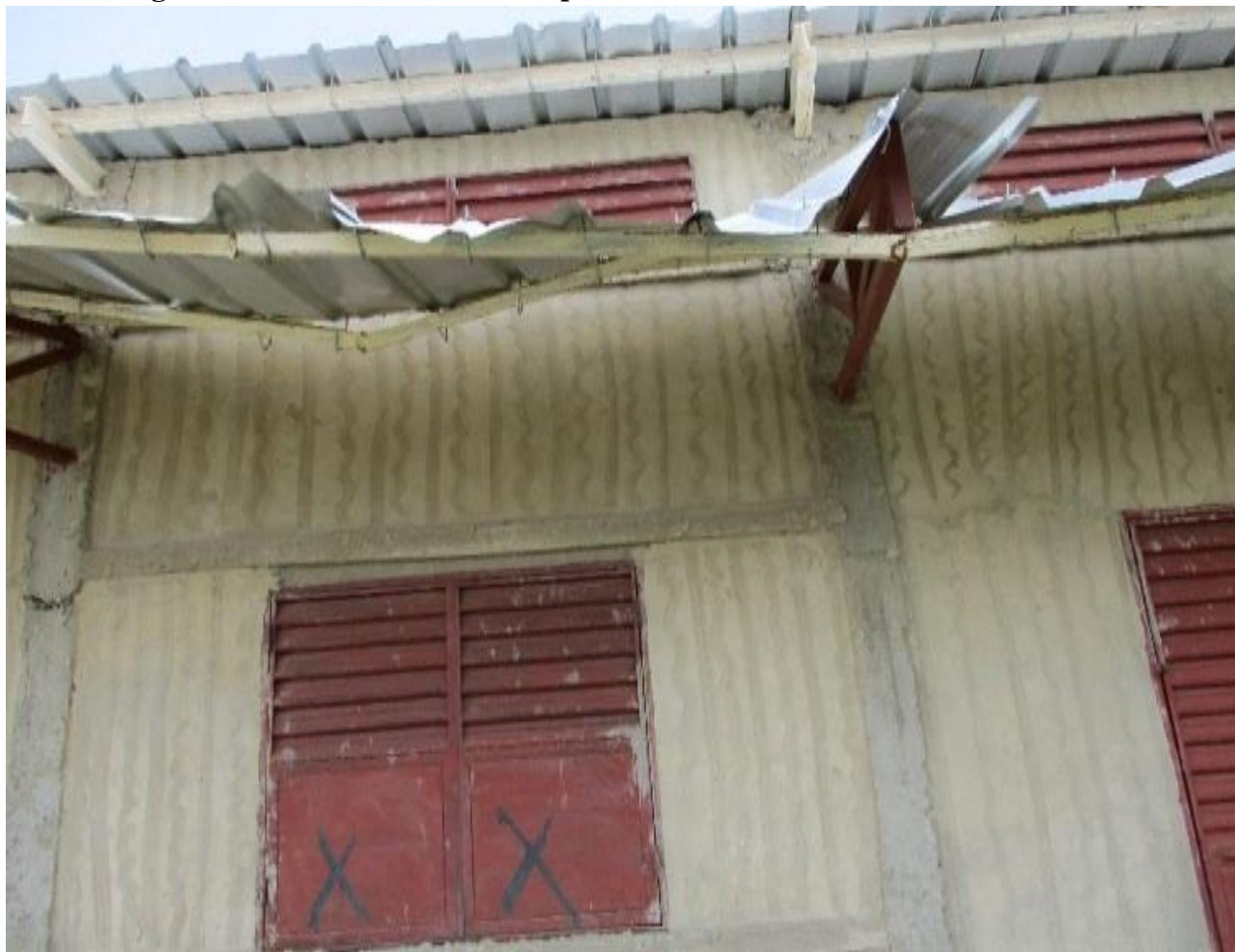
Photo 2 : Dégradation de la toiture à l'école primaire Diffa Koura
