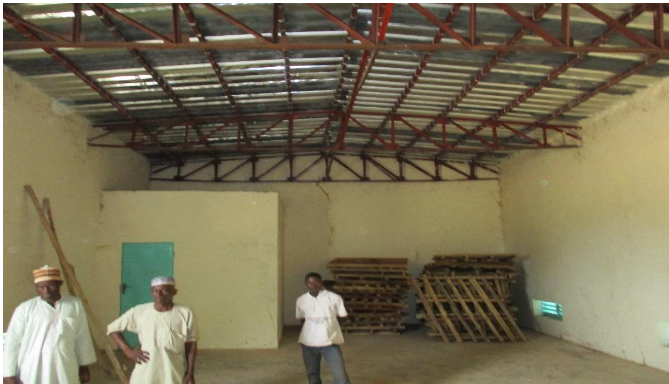
Photo 3 : Joint mal traité au niveau du magasin d'intrants zootechniques et vétérinaires de Chétimari
